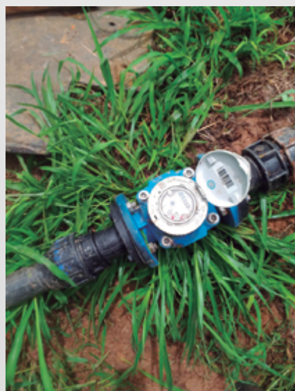
Hidrômetro instalado em CCA/Pilar
