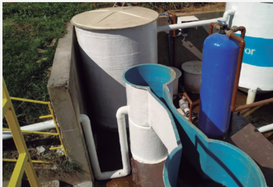
Nova Estação de Tratamento de Efluentes da Unidade Pilar
