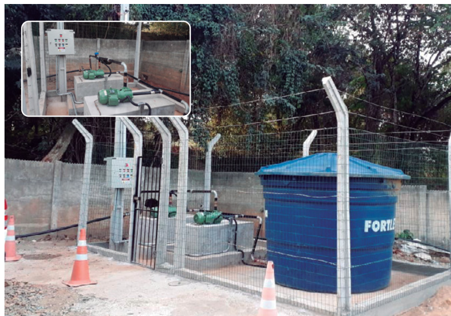
A estação de bombeamento foi instalada no estacionamento da unidade
