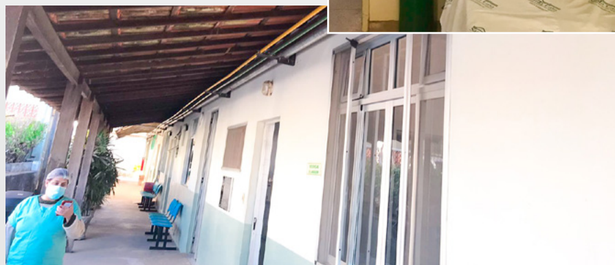
A tubulação que distribui gases medicinais, como oxigênio (foto acima)
